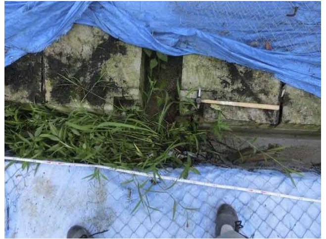
写真 39 4 段目立て排水溝交差部の変位
