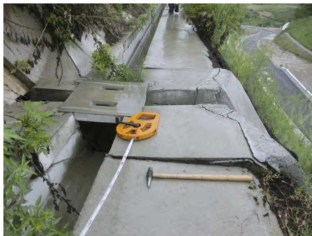
写真 45 4 段目小段コンクリートの沈下・横移動
