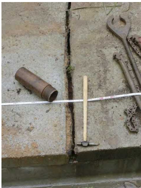
写真 28 3 段目小段コンクリートの目地開口
