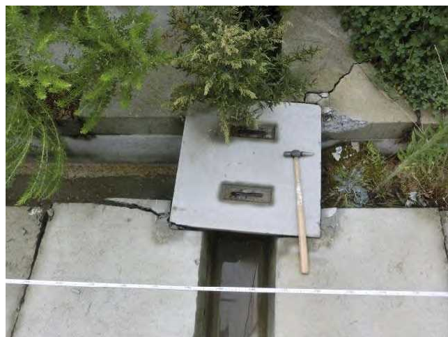
写真 36 3 段目排水溝交差部変状
