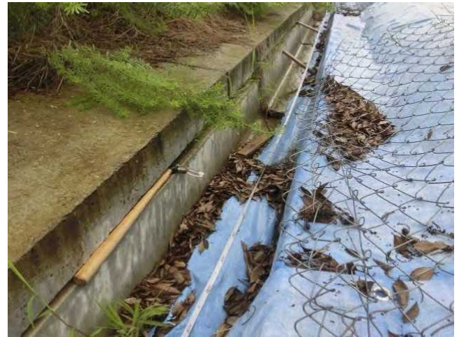
写真 20 2 段階目小段の沈下
