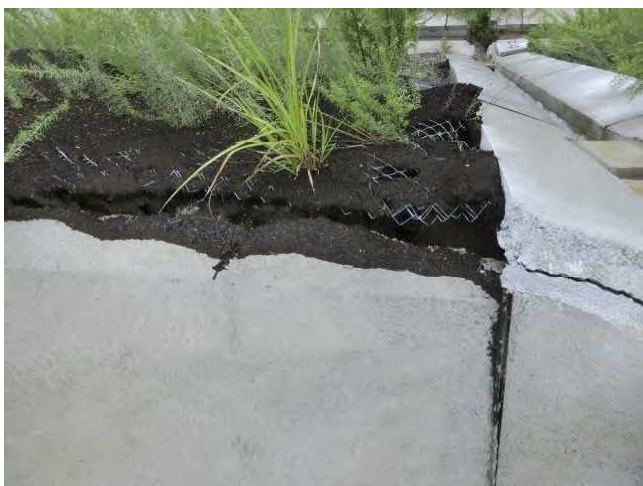
写真 46 4 段目小段のり肩、縦排水溝周辺の土砂侵食
