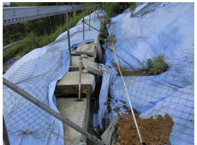
写真 16 2 段目小段・縦排水溝交差部の変状
