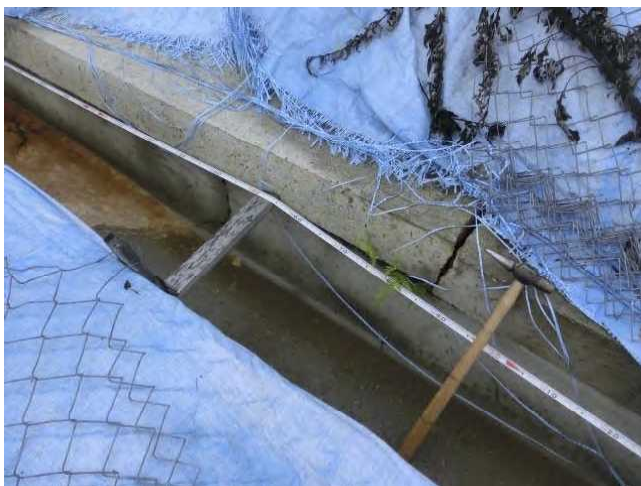
写真 15 2 段目排水溝山側の変状
