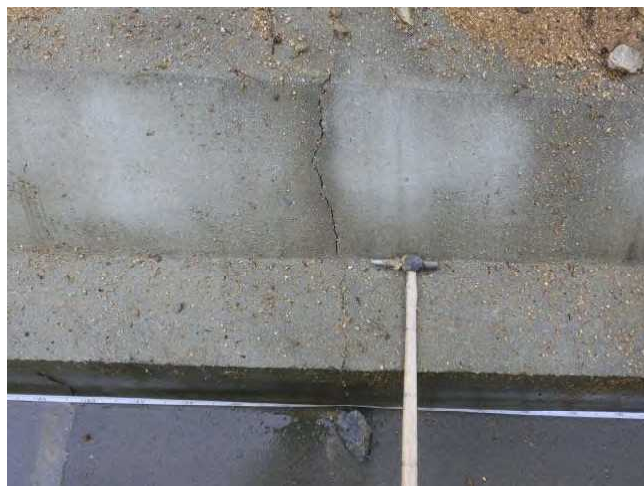
写真2 最上部（0段部）小段排水溝山側の亀裂
