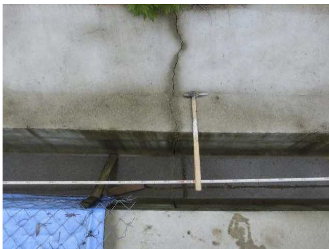
写真3 1段目小段排水溝山側の亀裂
