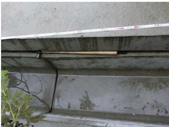
写真 44 4 段目小段、排水溝の沈下
