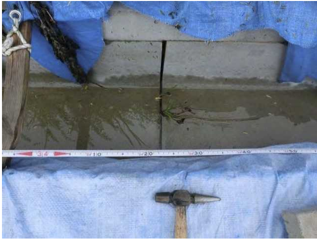
写真 38 4 段目排水溝目地の開口
