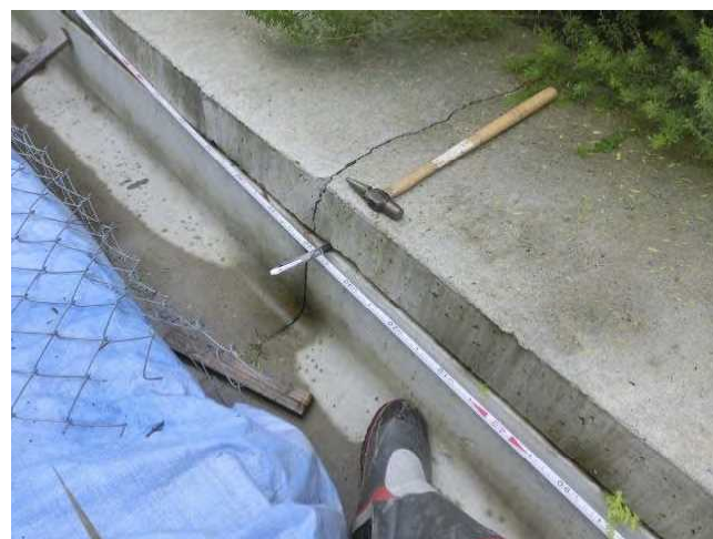
写真12 2段目小段コンクリート亀裂・排水溝沈下
