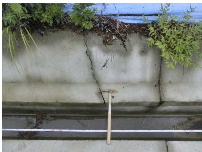
写真9 1段目小段排水溝山側の亀裂
