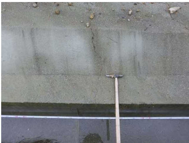
写真1 最上部（0段部）小段排水溝山側の亀裂
