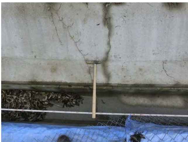
写真5 1段目小段排水溝山側の亀裂
