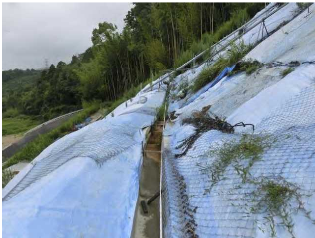
写真 13 2 段目小段・排水溝の沈下
