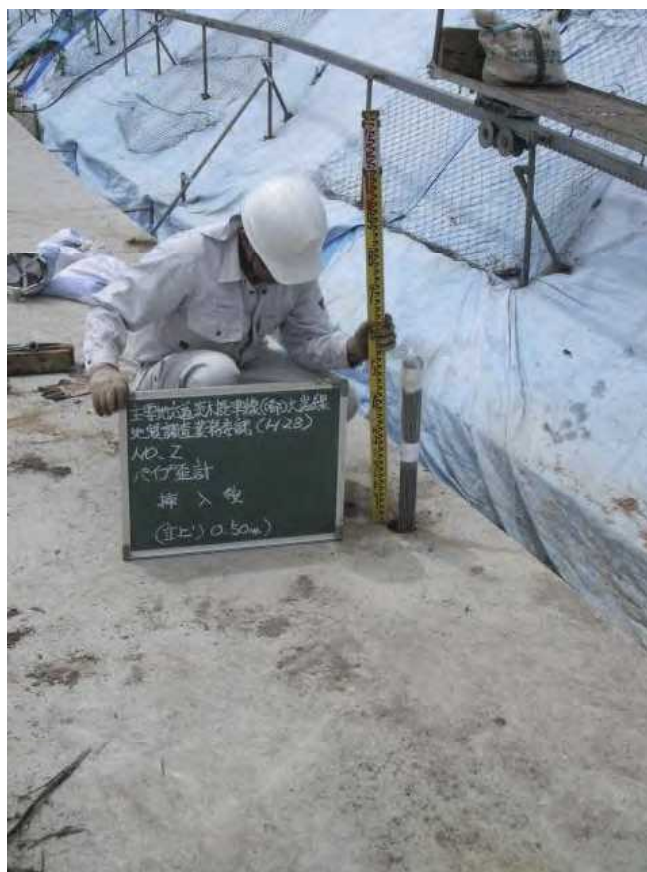
パイプ歪計残尺 (0.50m)
