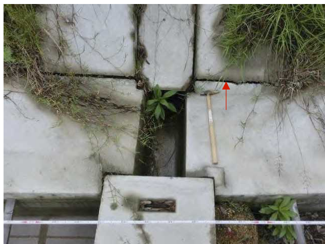
写真6 1段目小段排水溝と縦排水溝交差部付近の開口
