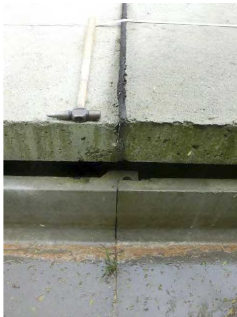
写真 34 3 段目小段、排水溝の沈下
