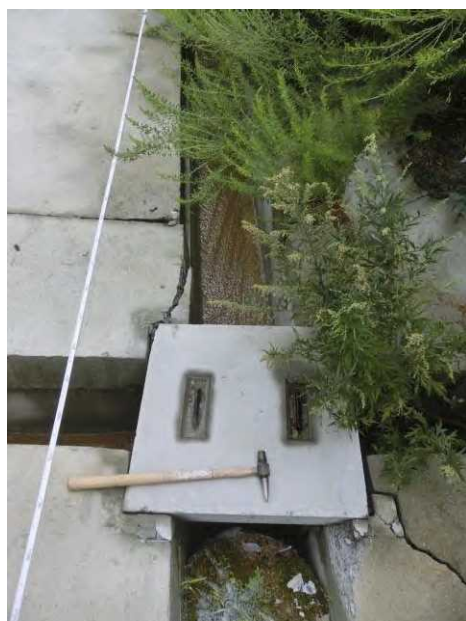
写真 36 3 段目排水溝交差部変状
