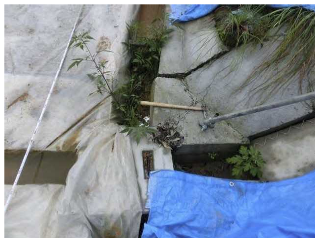
写真 32 3 段目排水溝交差部変状
