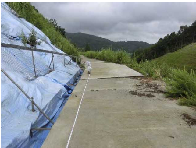
写真 33 3 段目小段谷側の浮き上がり
