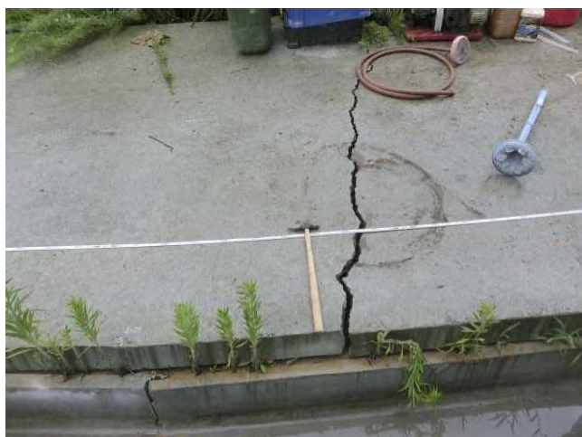
写真 29 3 段目小段コンクリートの亀裂・横移動
