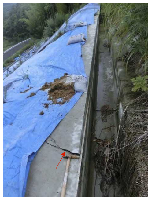
写真10 1段目小段コンクリートの亀裂
