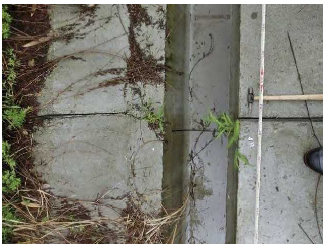
写真 26 3 段階目小段コンクリートの目地開口
