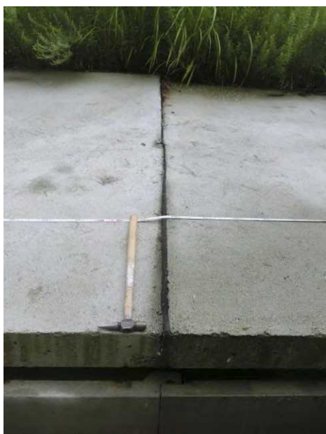
写真 35 3 段目排水溝の沈下と小段谷側の浮き上がり
