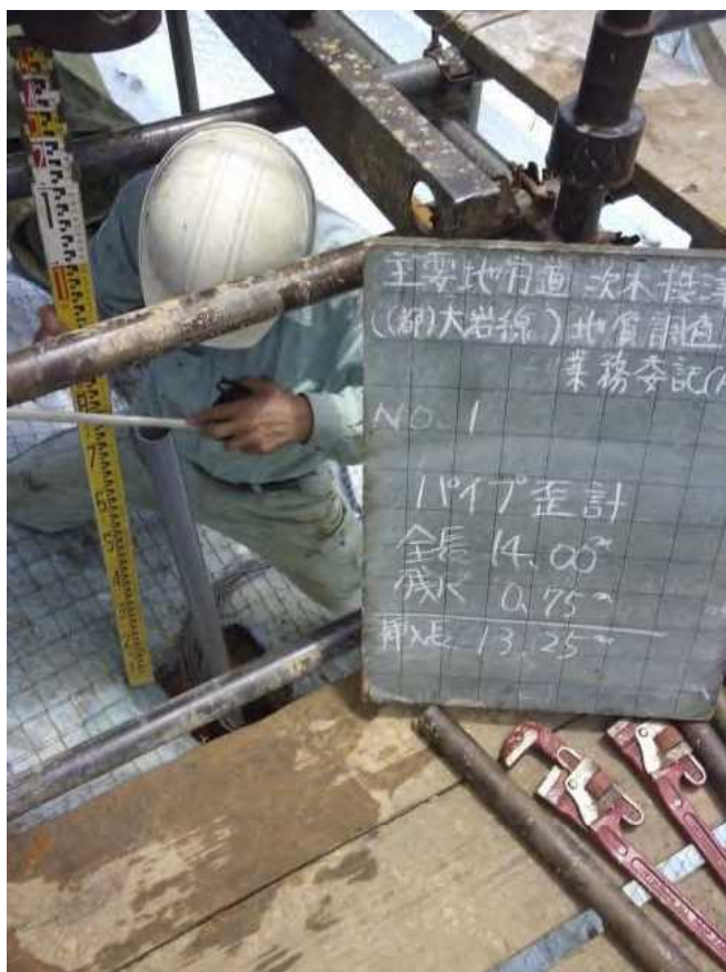
パイプ歪計残尺 (0.75m)
