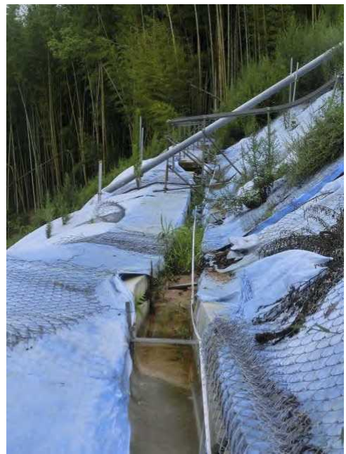
写真 14 同左。排水溝へ土砂流入
