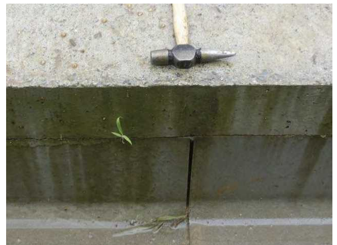
写真 27 3 段階目排水溝の目地開口
