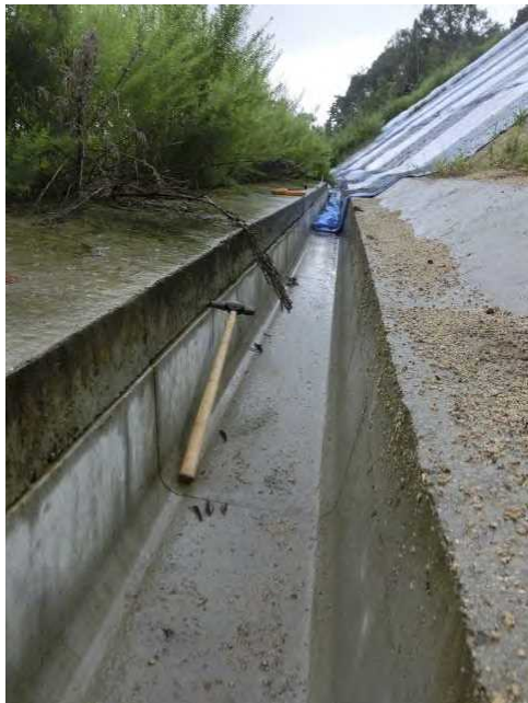
写真 21 2 段階目小段の沈下
