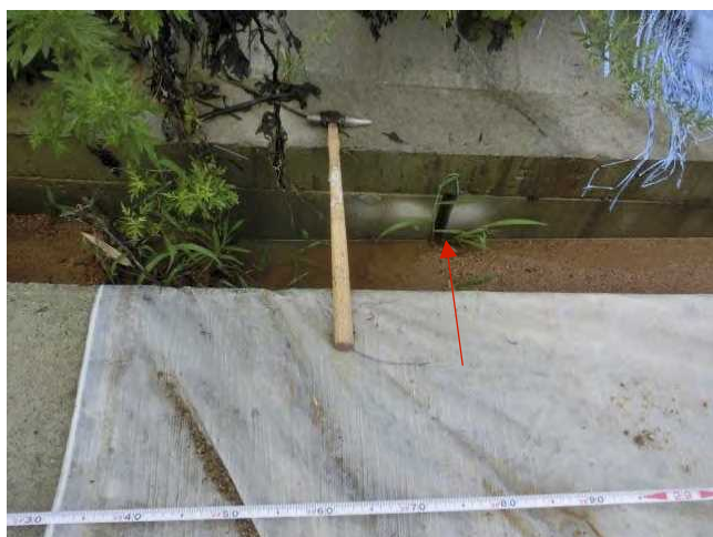
写真 31 3 段目小段排水溝の目地開口
