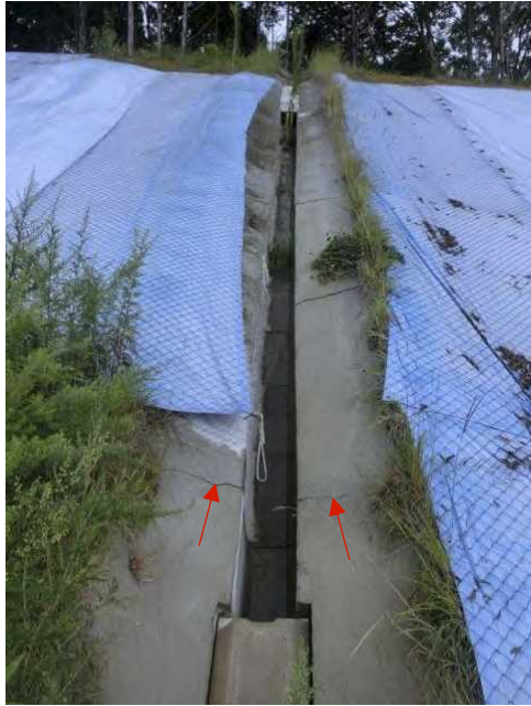
写真 19 2 段階目法面、縦排水溝の亀裂
