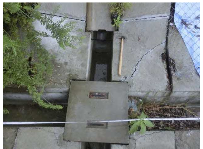
写真 18 2 段目小段、排水溝交差部の亀裂
