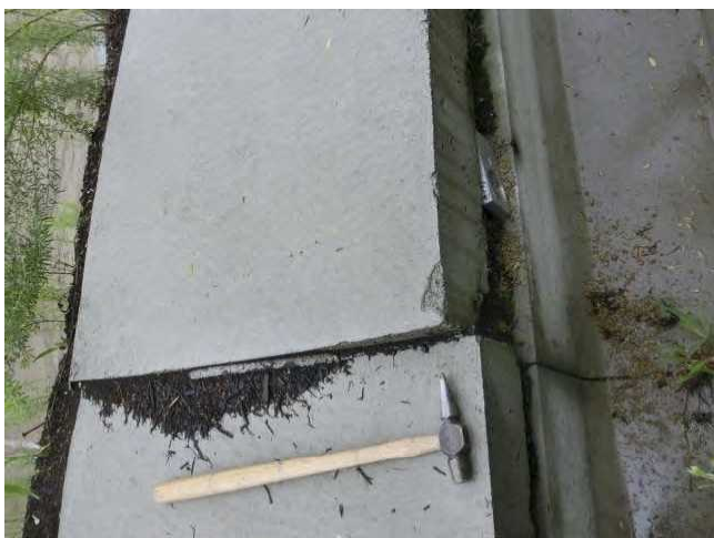
写真 48 4 段目小段コンクリートの沈下・横移動
