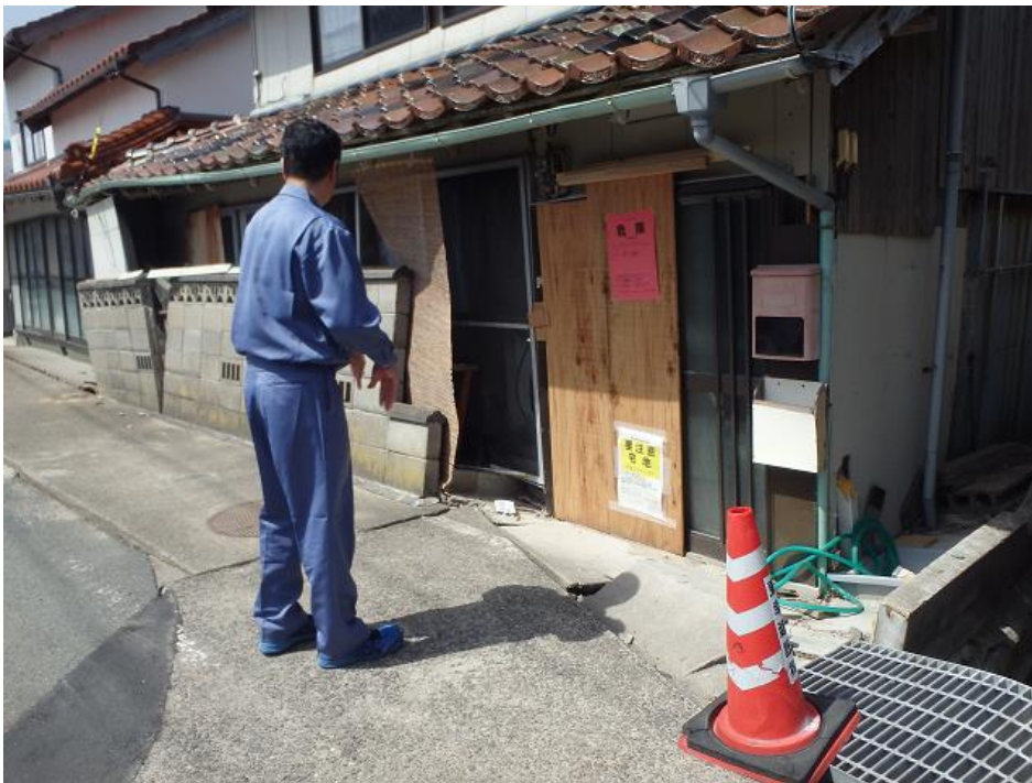
図4. 久手町羽根西地区の住宅（約20cm地盤沈下している）
